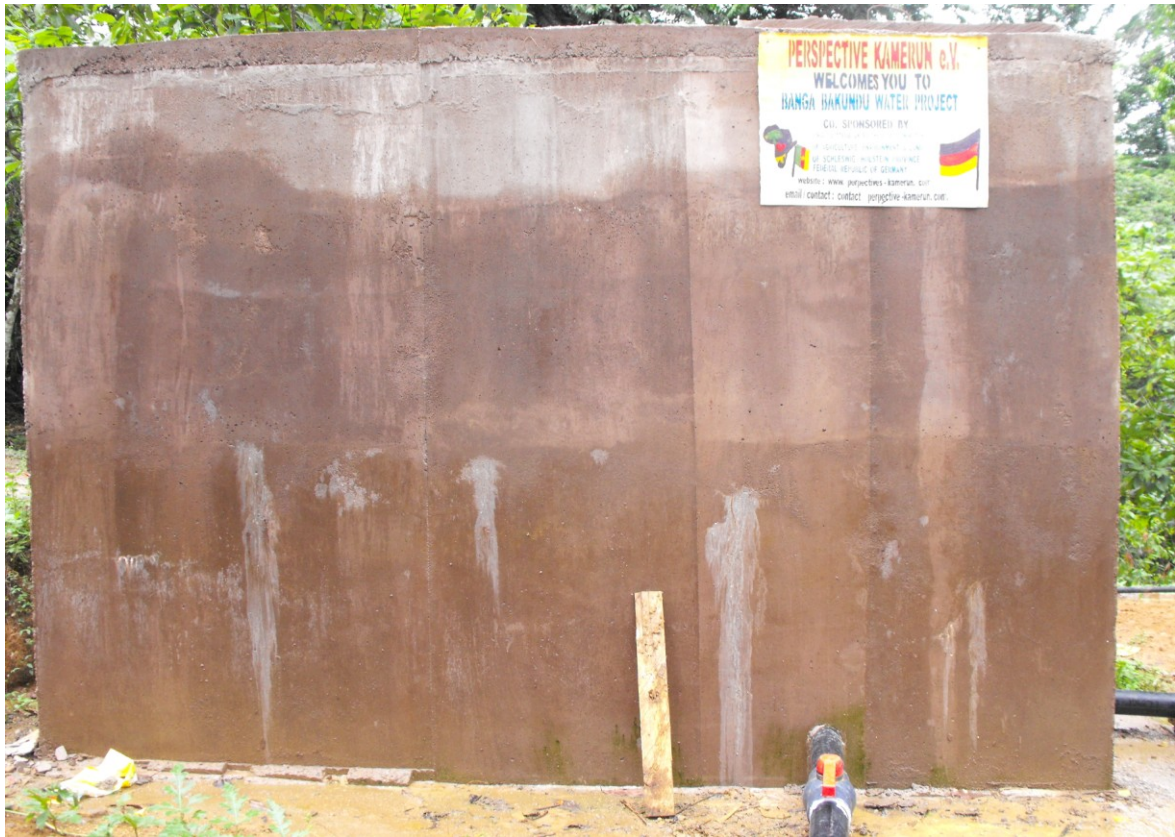
Ein Wasserspeicher mit Ausgangsröhr
